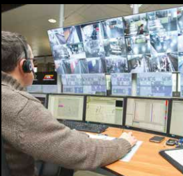
Salles de commande et de contrôle
